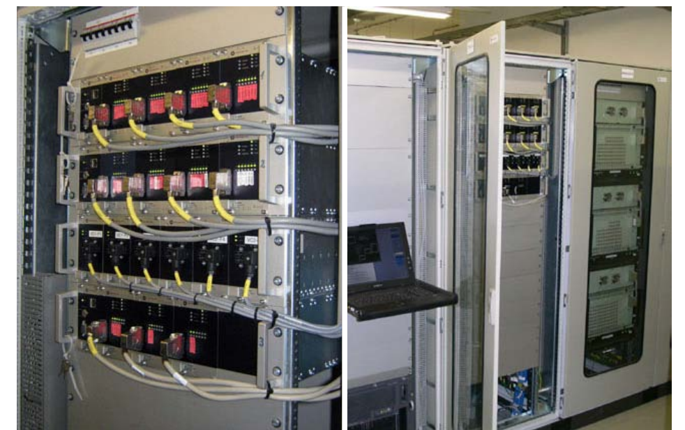
Serverschränke der Firma Borealis mit Compass 6000-System. Der Server, das VC-6000™-System und das COMPASS Classic-System sind in den ersten drei Schränken auf dem rechten Bild untergebracht. Das linke Bild zeigt eine Nahaufnahme des VC-6000™ (mittlerer Schrank).
