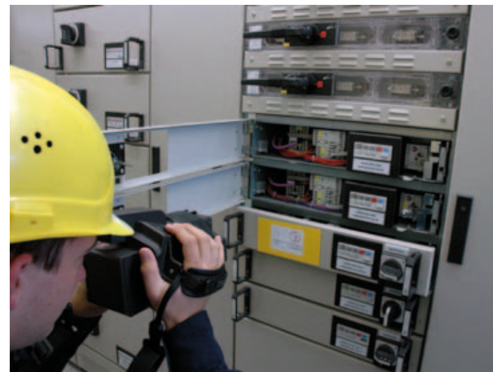
Untersucht werden in Betrieb befindliche Hoch- und Niederspannungsschaltanlagen
